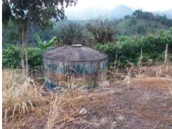
Imagen 2.1.21: Abastecimiento de agua a la población a través de tubos. Tanque reservorio
