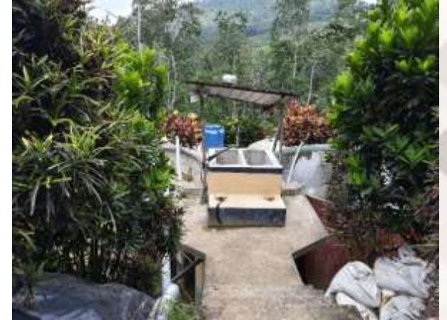
Imagen 2.1.23: Planta de Agua Potable Rio Chico
