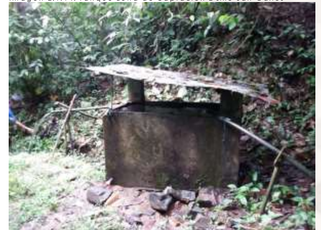
Imagen 2.1.14: Tanque zona de captación 2 sitio San Carlos
